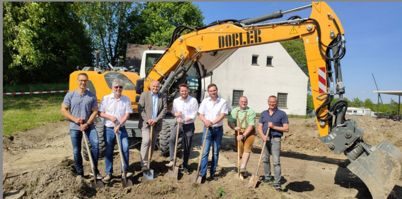
v.l.n.r. Bauamtsleiter Stefan Bissinger, Gemeinderatsmitglied Werner Rauch, Bürgermeister Martin Paninka, Michael Torpier (SLI Ingenieure), Gemeinderatsmitglied Julian Bumberger, Bauhofmitarbeiter Wolfgang Pohl und Bauhofleiter Michael Schmidt setzten Mitte Mai gemeinsam den ersten Spatenstich für das neue Wasserhaus. Foto: Diana Sonntag
