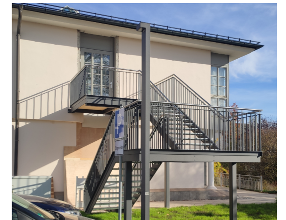
Die neu gebaute Fluchttreppe dient erstmalig als Zugang für den Sitzungssaal. Foto: Diana Sonntag
