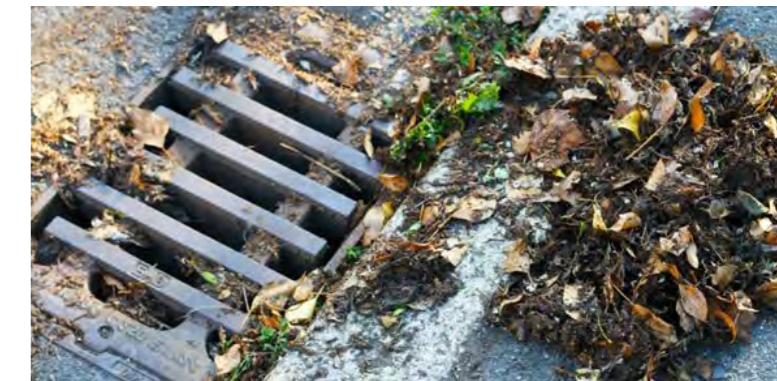
Ein verstopfter Sinkkasten kann zu Überschwemmungen führen.
