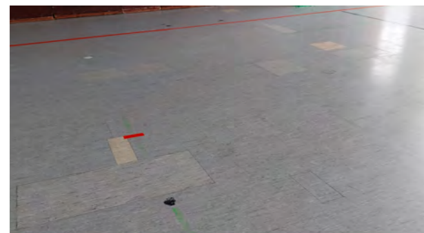
Ein großer Flickenteppich - der Schmutterhallenboden muss saniert werden. Foto: Martin Paninka
