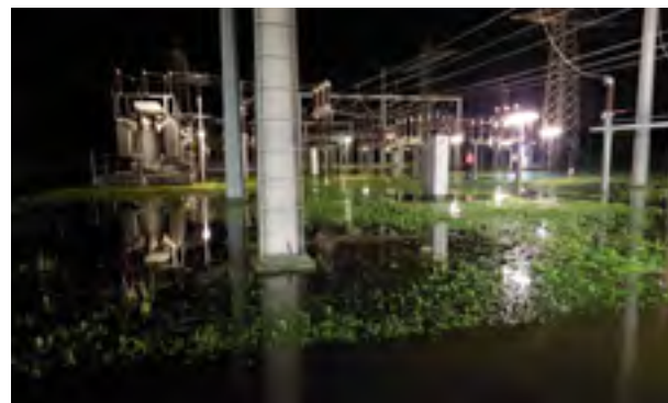
Das Umspannwerk stand auch unter Wasser, konnte aber gerade noch gesichert werden. Foto: Martin Paninka
