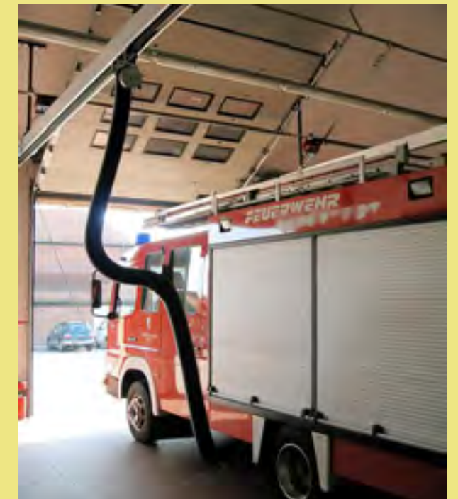
Absauganlage der Feuerwehr. Foto: Stefan Bissinger
